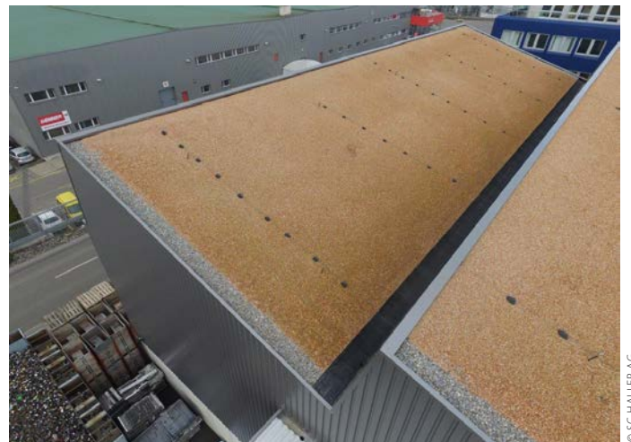
Da Resitrix einlagig verbaut werden kann, waren die 1800 Quadratmeter Fläche sehr schnell abgedichtet.
